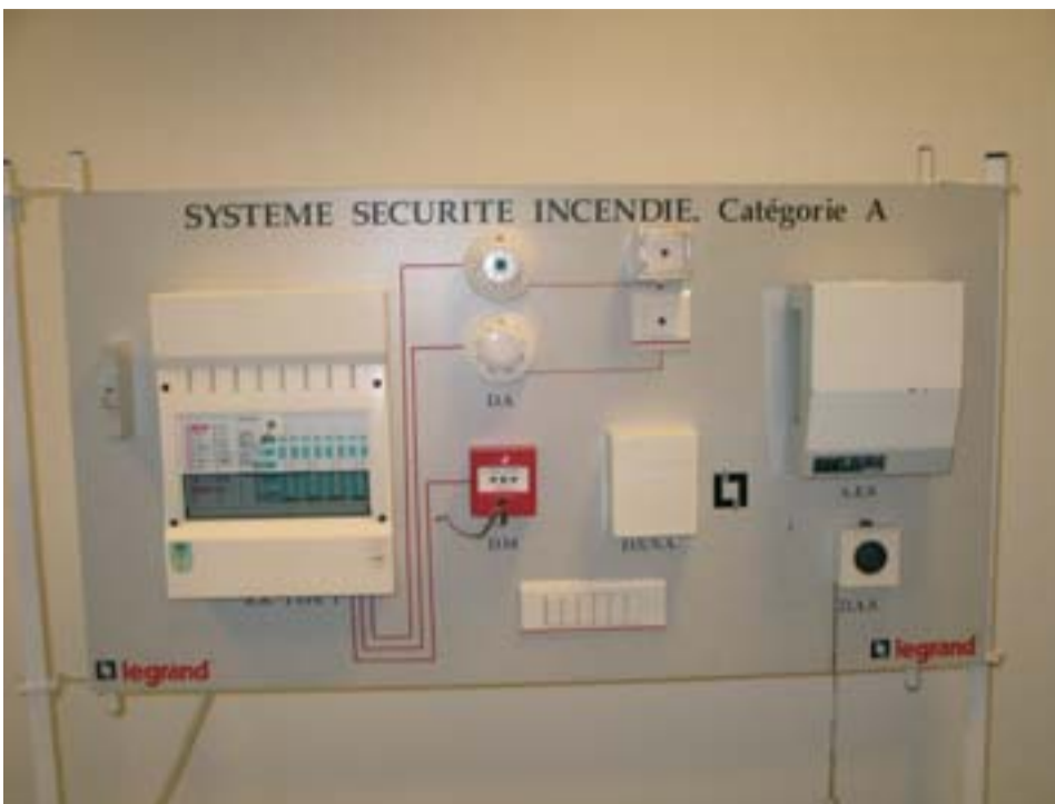
Il ne reste que quelques mois aux hôteliers pour se préoccuper de la mise en conformité de leur établissement.
